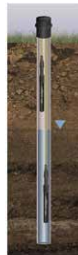
Barologger 5 e Levellogger 5 instalados em Poço utilizando Cabos de Leitura Direta L5
